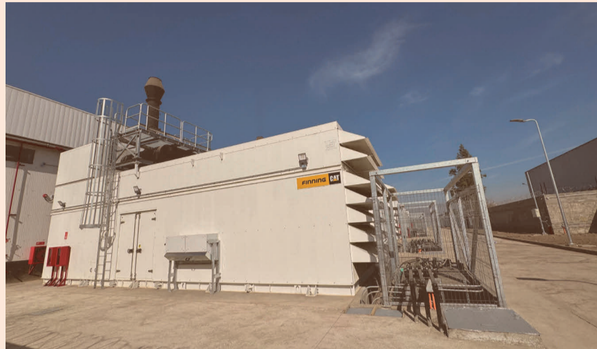
Generadores Caterpillar integrados por Finning: soluciones diseñadas y desarrolladas localmente que garantizan continuidad energética, cumplimiento normativo y soporte técnico 24/7 para Data Centers del país.
