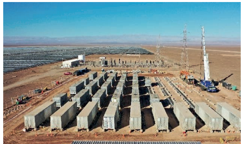
Proyecto BESS de Transelec para Granja Solar de Copec, uno de los sistemas de almacenamiento energético de mayor escala del país, con 420 MWh de capacidad.
